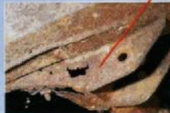
Die hintere Blattfederaufnahme und was der Rost davon übrig ließ
