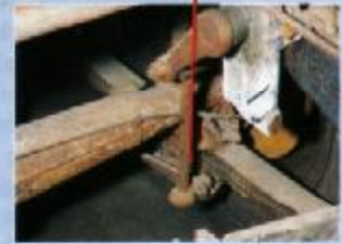
Sorgt für schwammiges Fahrgefühl: ausgeschlagene Blattfederaufnahme
